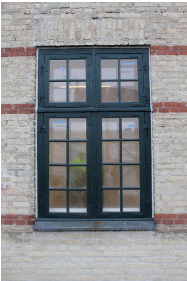
Vinduerne i afd. 100 – Bindesbøll undergår en større renovering, da de ikke bare må udskiftes
